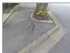
【道路舗装への影響】
