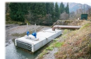
小水力発電施設
