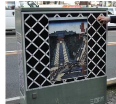
ラッピングされたトランスボックス （藤沢地区）（広報ふじさわより）
