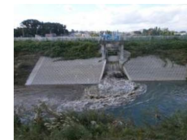
今田遊水地排水ゲート (神奈川県 HP より)
